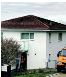
Tonziegeldach mit Schwarzalgenbefall.
