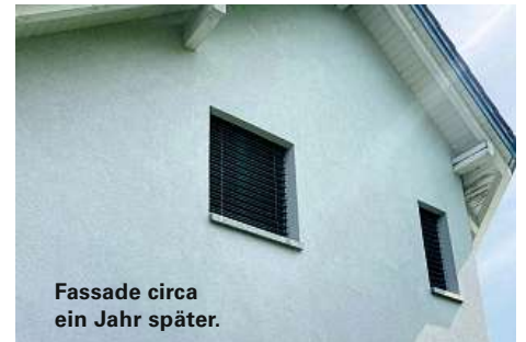
Putzfassade mit Grünalgenbefall
