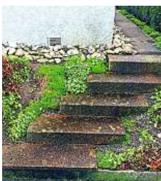
Treppe mit Flechtenbefall.
